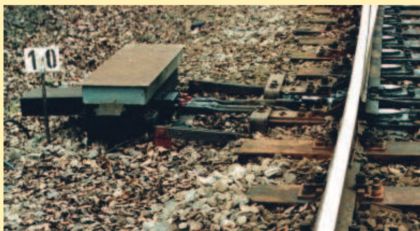
Fot. 4. Elektryczny napęd rozjazdowy w oryginalne.
